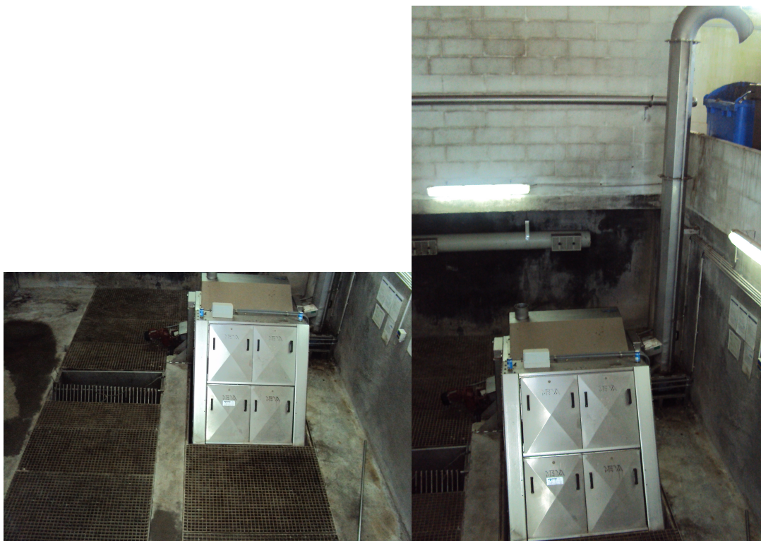
Figura 4 – Equipamento de gradagem e remoção de sólidos antes da entrada no poço
