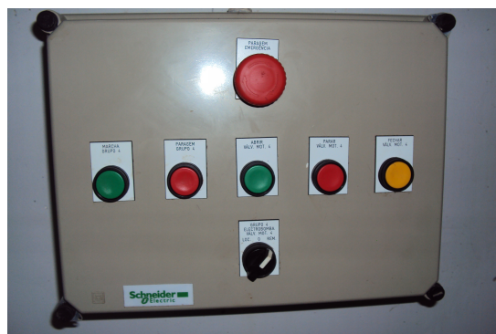
Figura 7 – Painel de instruções de um dos grupos eletrobomba
