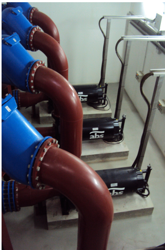
Figura 5 – Vista da sala de bombagem
