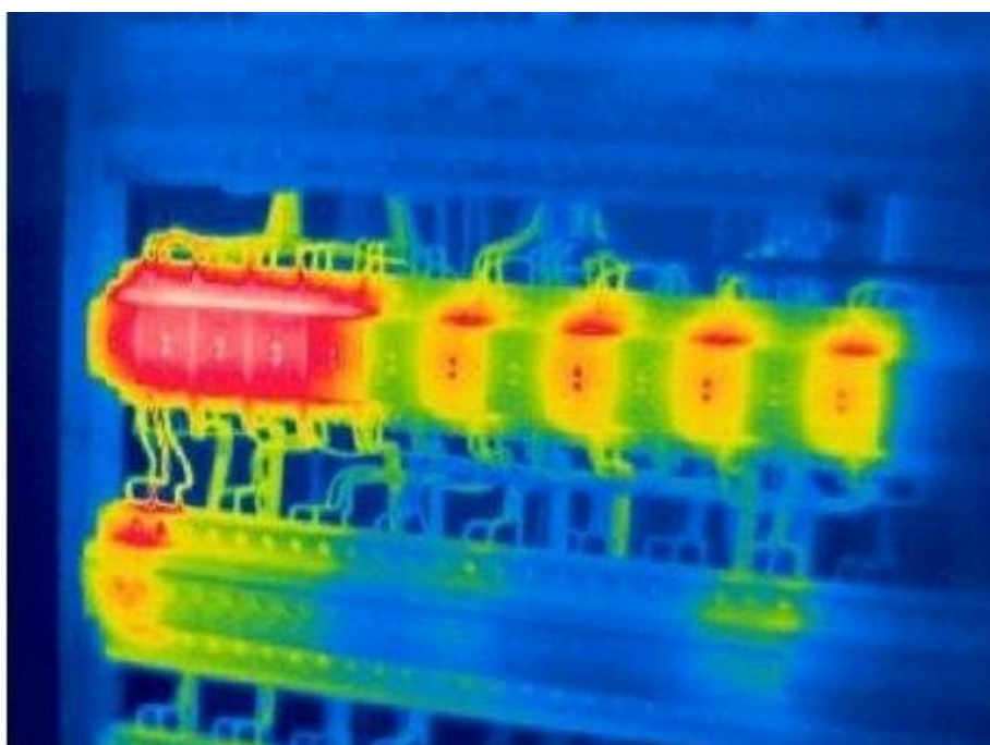
Obr. 8.10 rozložení teploty na jistých prvcích na rozvaděči[15]
