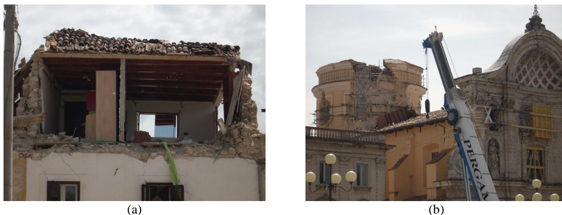
Figura 7: Exemplos de danos ocorridos em edifícios de alvenaria de pedra, Itália 2009: (a) edifício habitacional em Onna; (b) colapso da cúpula de S. Massimo em L'Aquila.
