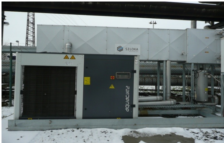
Obr. č. 11 - Moderní technologické zařízení „SILOXA“ pro sušení plynu
