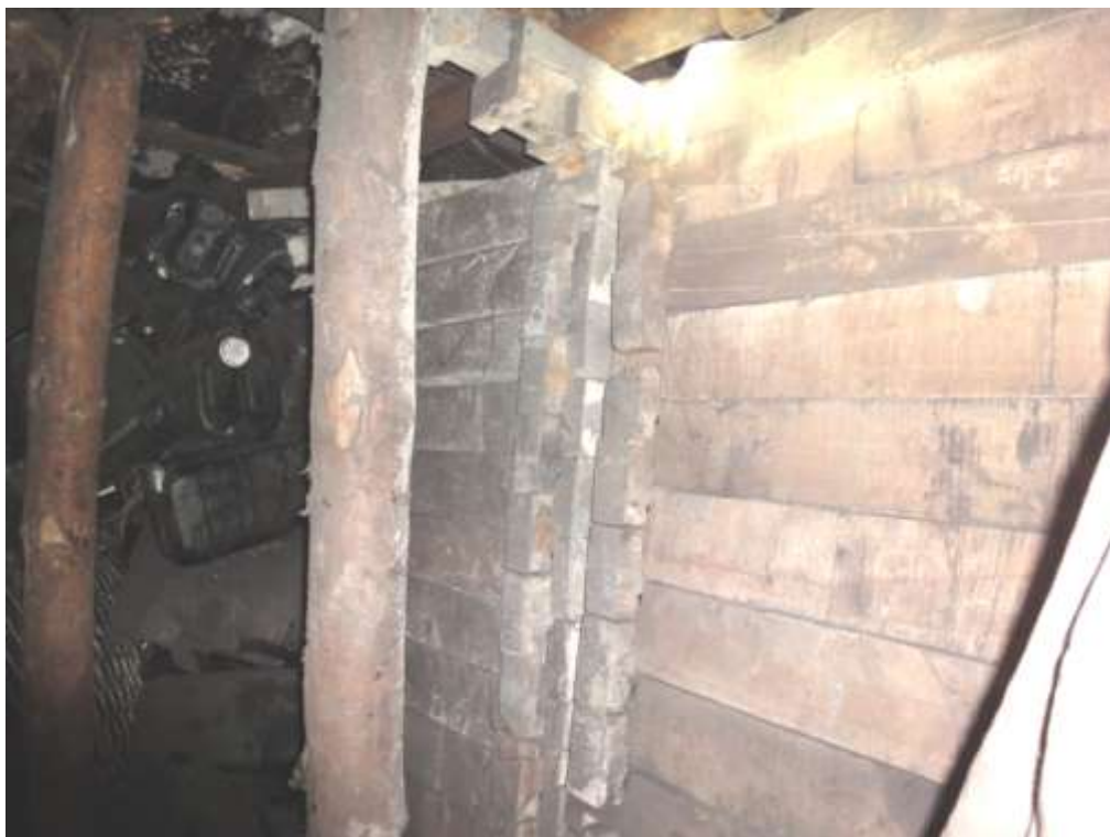
Obr. 1 Ochranné žebro na třídě 063 5346 (těžní chodba porubu 063 606) . Foto: D. Sulava
