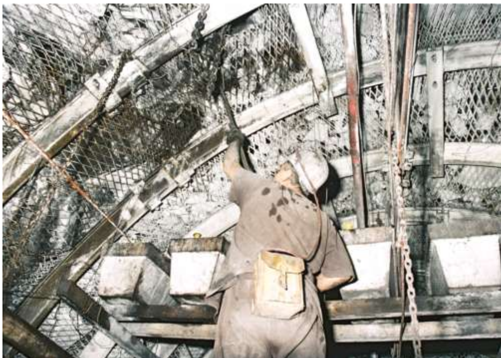
Obr. 12 Instalace pramencové kotvy typu IR-4E/W délky 12 m do vývrtnu na třídě č. 063 5346, firmou Novum Servis Sp. z. o. o.. Foto: L. Mazal
