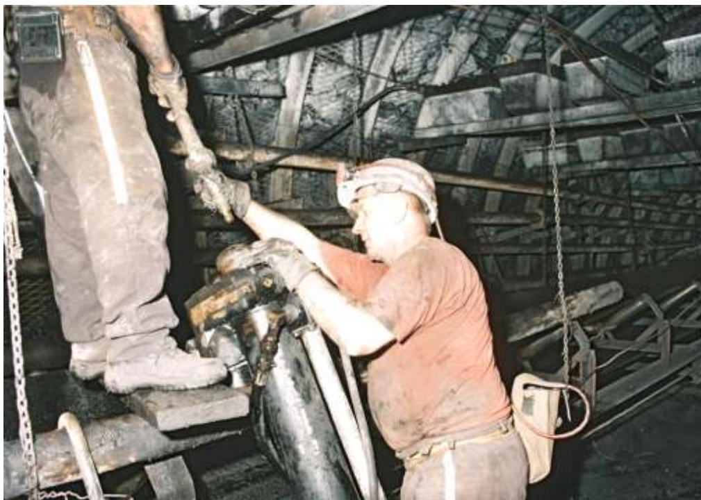
Obr. 14 Instalace pramencové kotvy pomocí vrtací a svorníkovací soupravy Super Turbo Bolter firmy Minova. Foto: L. Mazal
