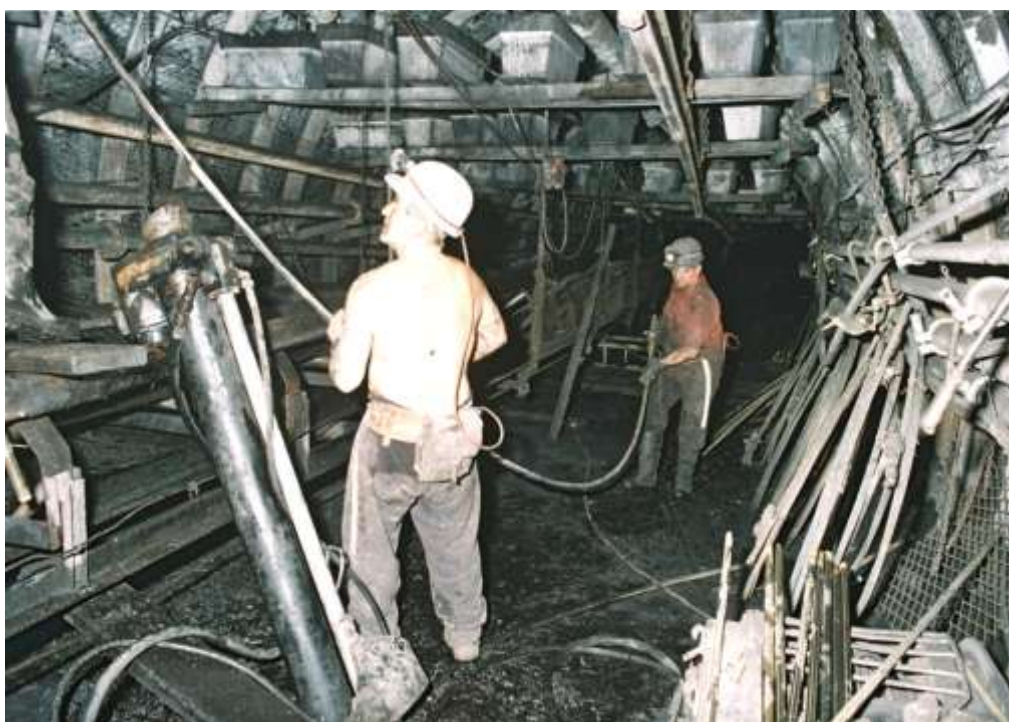
Obr. 13 Instalace pramencové kotvy typu IR-4E/W délky 12 m do vývrtnu na třídě č. 063 5346, firmou Novum Servis Sp. z. o. o.. Foto: L. Mazal
