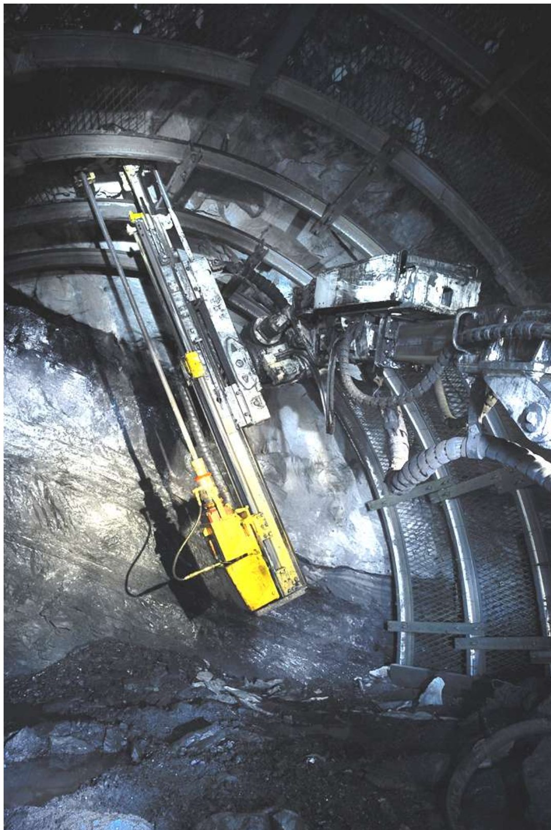
Obr. 7 Vrtání vývrtů pro svorníky vrtacím vozem DH-DT1 na třídě 063 5348. Foto: V. Halfar
