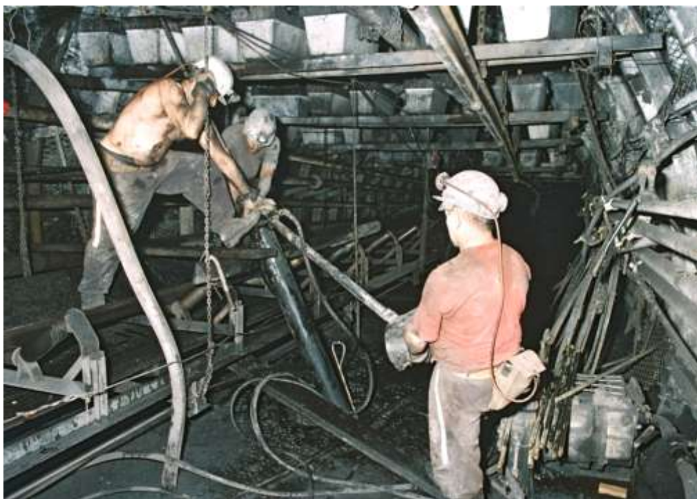
Obr. 15 Instalace pramencové kotvy pomocí vrtací a svorníkovací soupravy Super Turbo Bolter firmy Minova. Foto: L. Mazal
