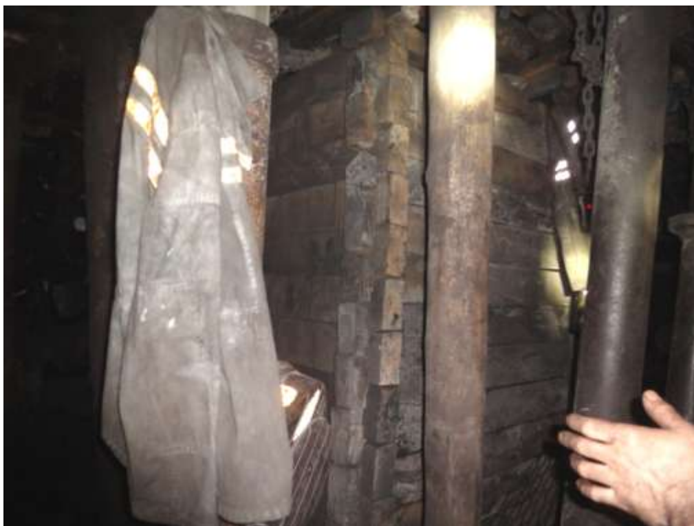
Obr. 18 Dřevěné hráně typu „LINK-N-LOCK“ na třídě č. 063 5346 za postupujícím porubem č. 063 606. Foto: D. Sulava
