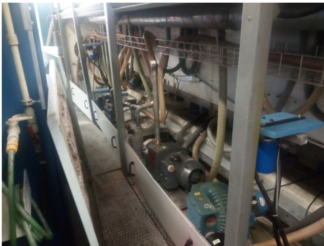
Obr. 9 Uložení vývěv a dmychadel v tunelu
