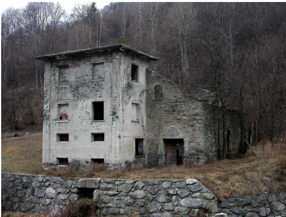
Figura 18 - La centrale idroelettrica in località l'Ila in fase di progressivo degrado (foto Cesti)
