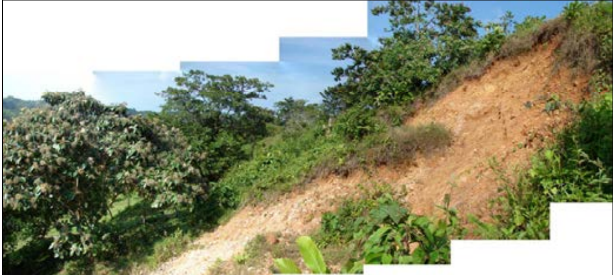
Figura 83. Deslizamiento de despeque de Guásimo (Fecha: 17/03/07)
