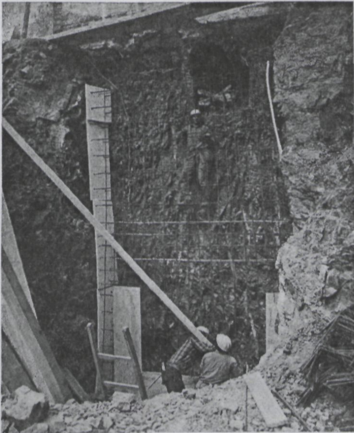
En este reportaje gráfico puede verse el estado en Abril de 1974, de las obras de vaciado y cimentación del futuro edificio colegial.
