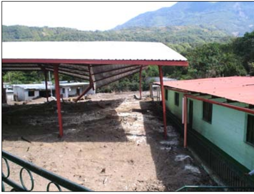
Figura 7. Edificio de la Escuela del Cantón Panabaj donde se observa la capa de lodo que cubrió el patio y el colapso parcial de la estructura metálica de la cancha de básquetbol.
