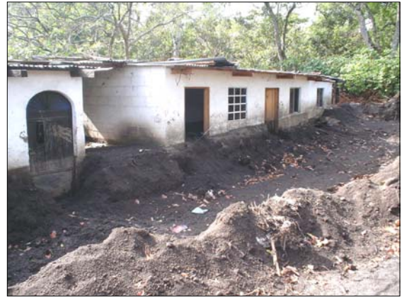
Figura 11. Ejemplo de vivienda en el Cantón Tzanchaj afectada por el lodo que incursionó en la vivienda.
