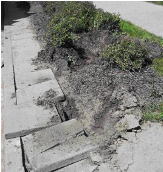
Obr. 11. Zničené dláždění vedle vozovky
