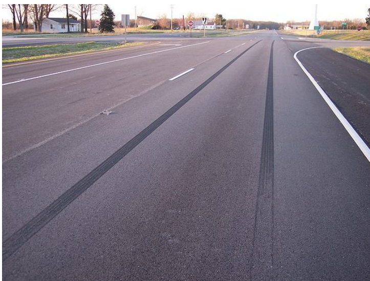
Obr. 3. Blokovací stopy na asfaltu
