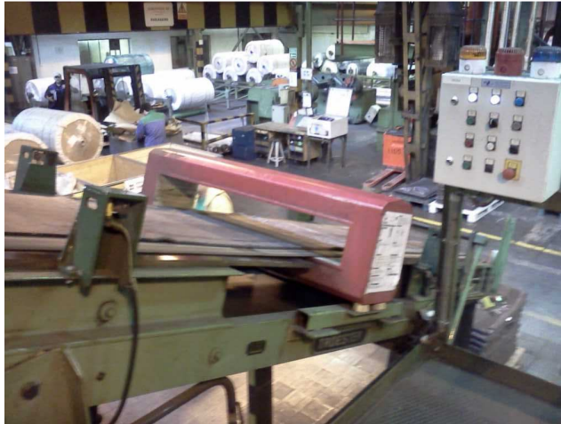
Obrázek č. 11: před zaváděním směsi prochází materiál přes detektor kovu
