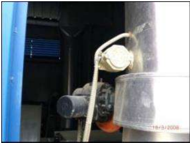
Φωτογραφία 4.2.2.6-1: Απαερίωση καλωδίων υψηλής τάσης
