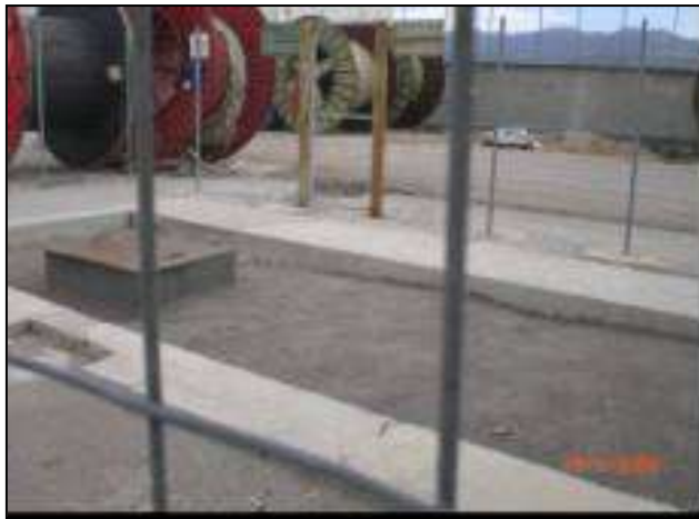
Φωτογραφία 4.4.3-1: Υπόγεια δεξαμενή προπανίου
