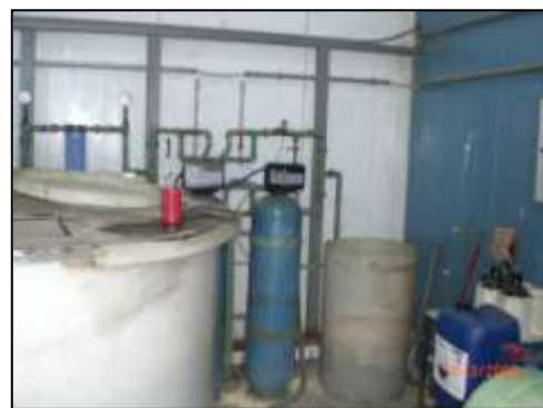
Φωτογραφία 4.4.1-2: Σύστημα αποσκλήρυνσης νερού
