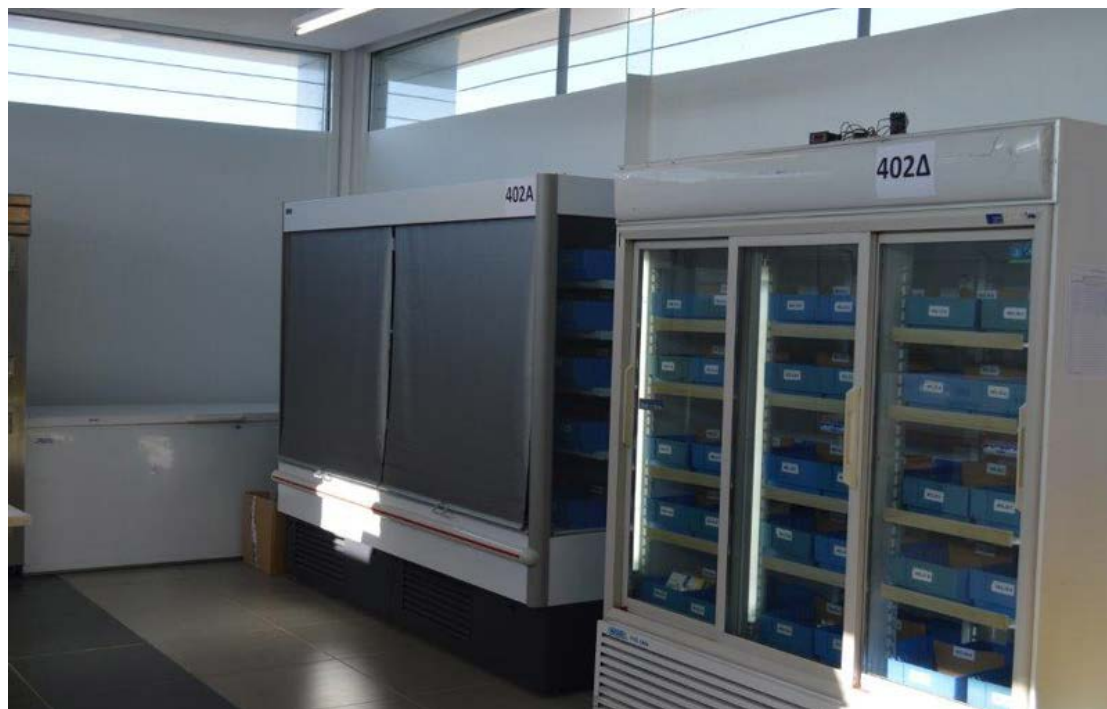
Εικόνα 12 Εγκαταστάσεις συντήρησης φαρμάκων σε φαρμακαποθήκες
