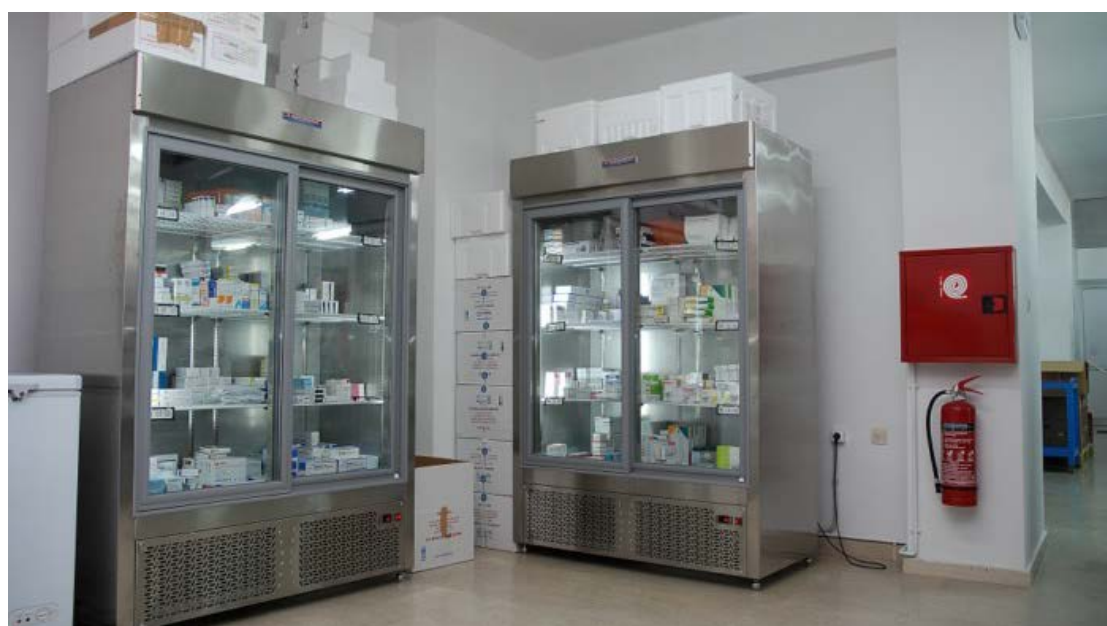
Εικόνα 13 Εγκαταστάσεις συντήρησης φαρμάκων σε φαρμακαποθήκες
