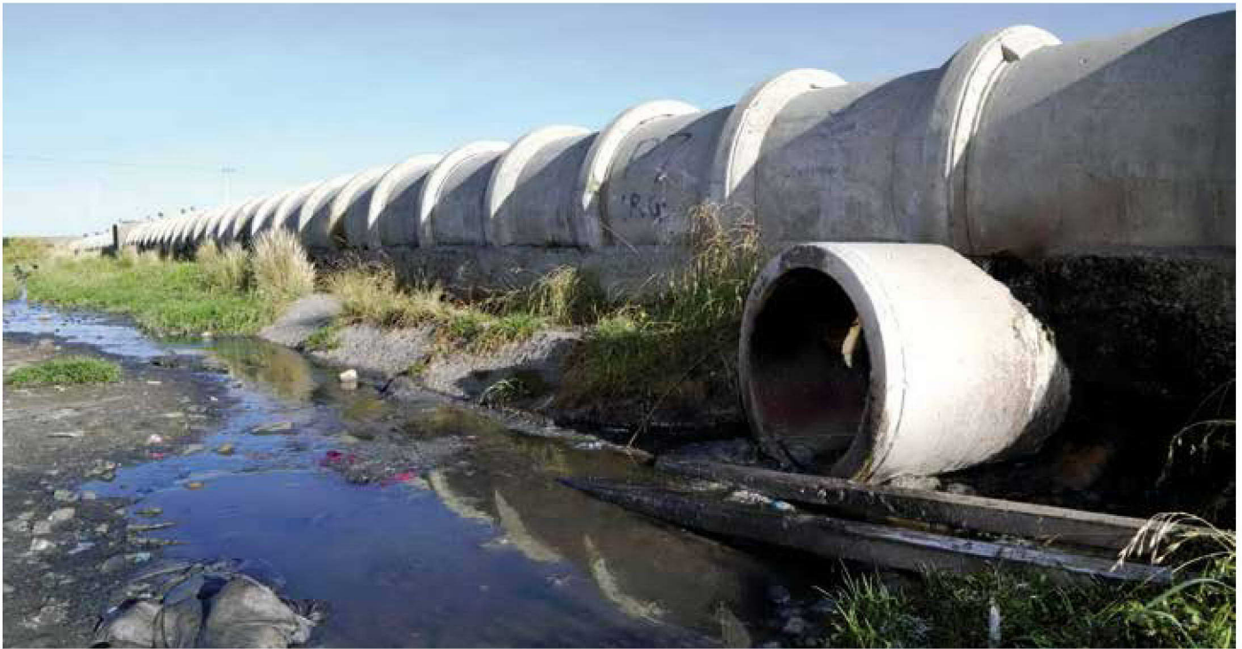
Línea principal de alcantarillado de la planta de tratamiento de aguas residuales de Puchukollo perforada por la población local para desviar el agua para el riego y la ganadería. Foto: Gabriel Barceló. Banco Mundial.
