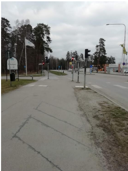
Obrázek 16 Indukční smyčka na cyklostezce před SSZ, Linköping, Švédsko; autor: Hlubučková, 2019
