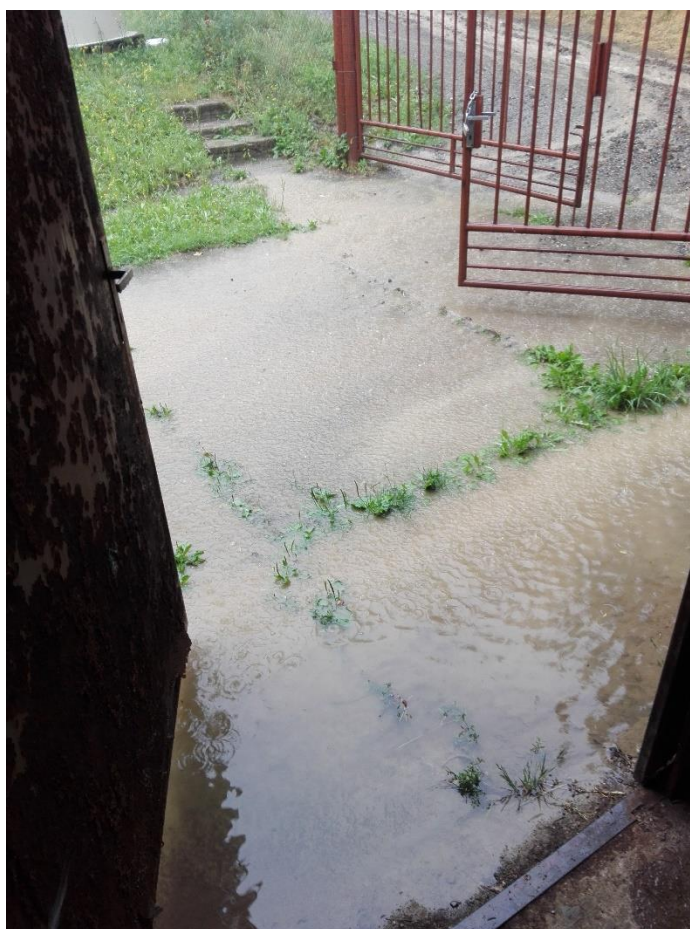
Obrázek 12: Problematika na ČOV v době dešťové události 3 [58]
