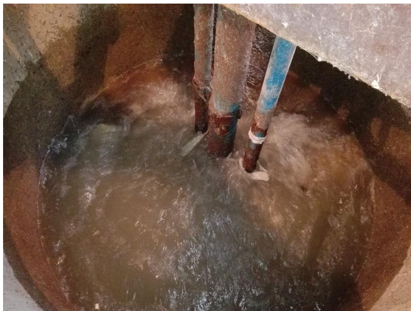
Obrázek 111: Problematika na ČOV v době dešťové události 2 [58]
