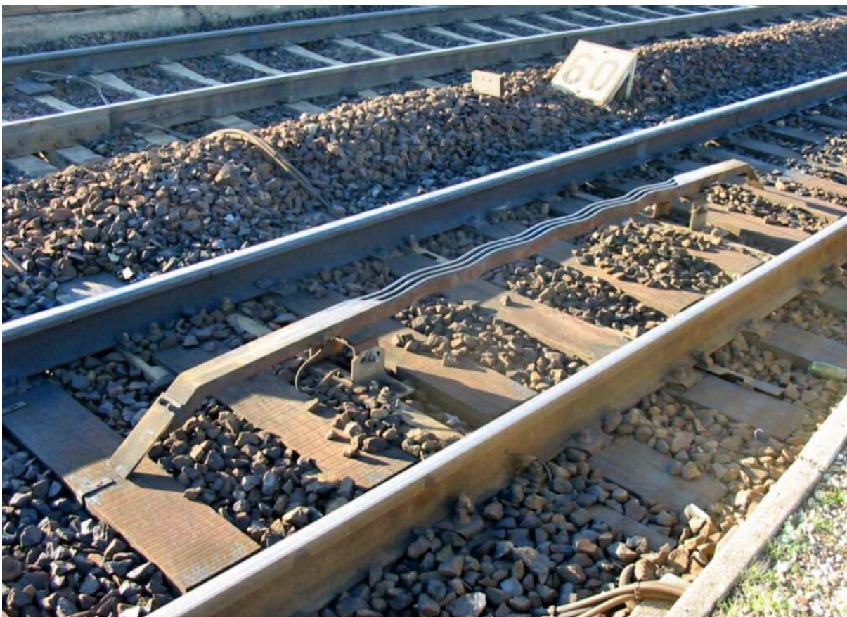
Obrázek 1 Kontaktní trámec „krokodýl“ vlakového zabezpečovače na síti SNCF. (zdroj [6])
