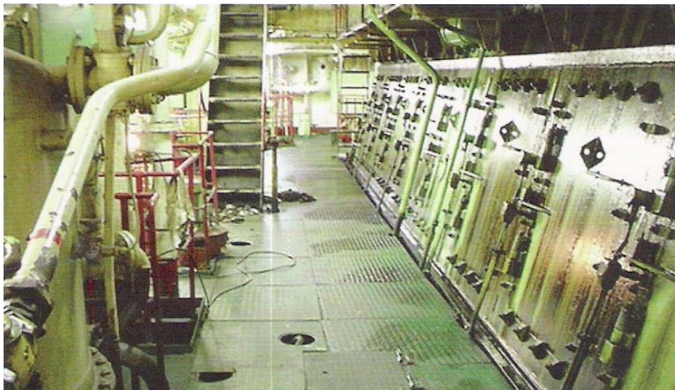
Εικόνα 17 : Engine room dirty
