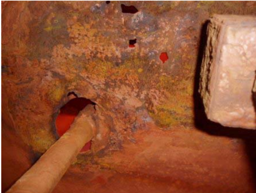
Εικόνα γ42 : Hole in hatch coaming
