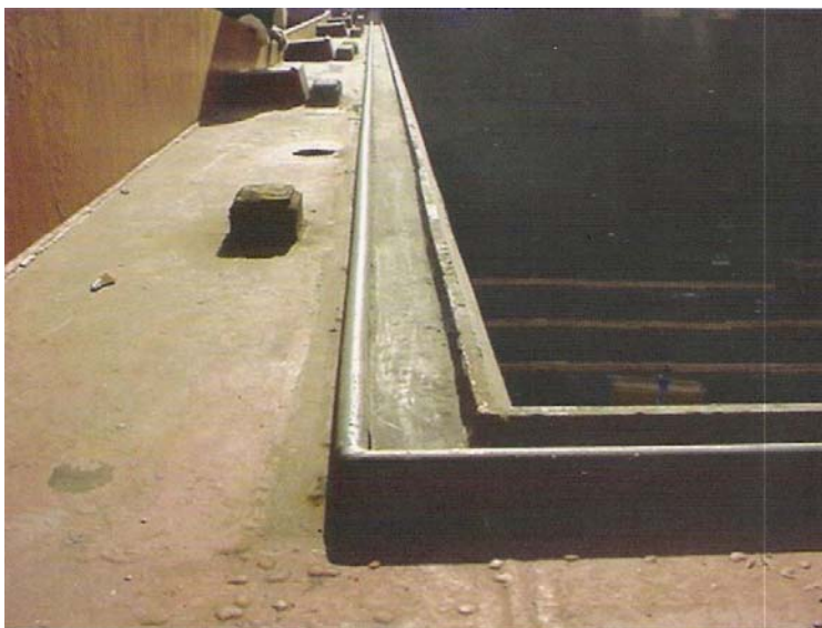
Εικόνα γ44 : Hatch coaming in good condition
