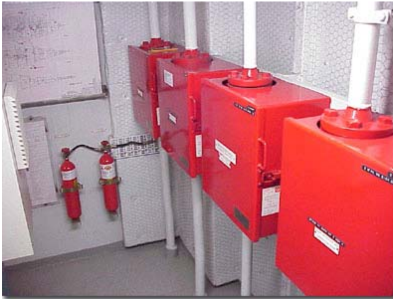
Εικόνα γ26: Fixed fire extinguishing system control boxes
