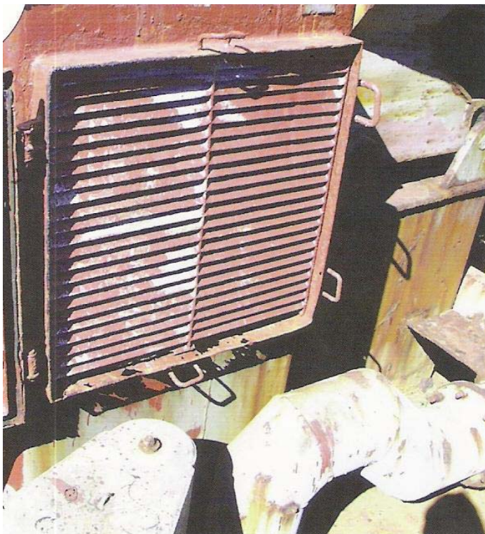
Εικόνα 15: Vent in bad condition
