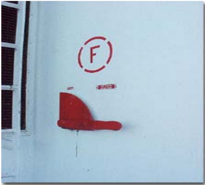
Εικόνα γ17: Fire-damper opening-closing lever
