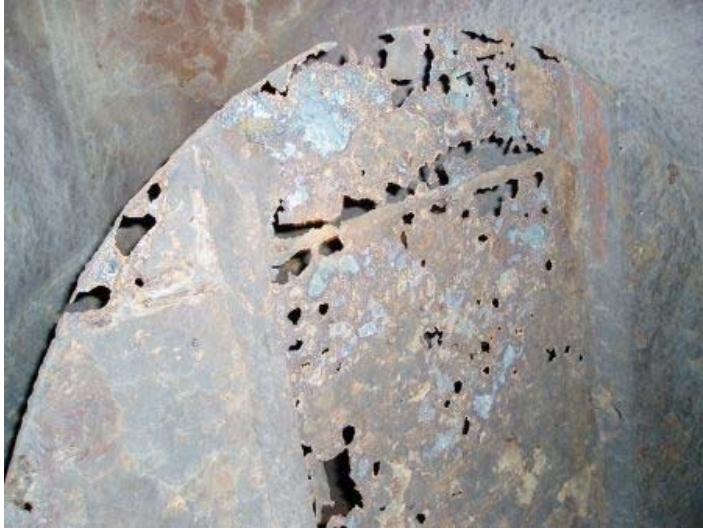
Εικόνα γ19: Engine room fire damper deteriorated
