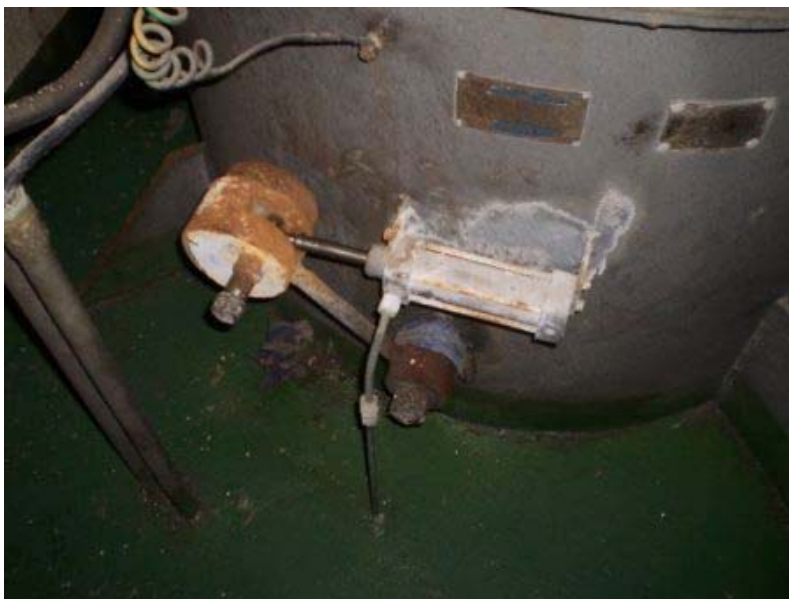
Εικόνα γ21: Fire damper actuator unable to release flap
