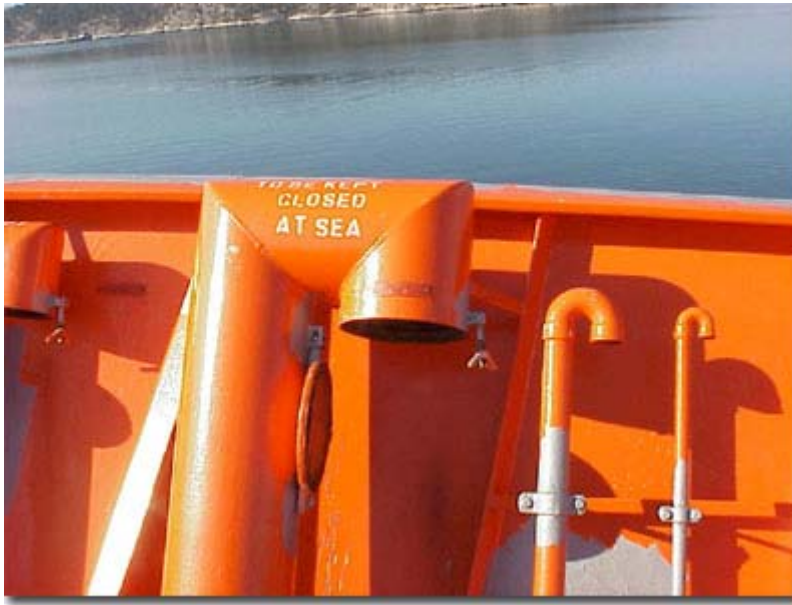
Εικόνα γ38: Gooseneck air pipe in good condition
