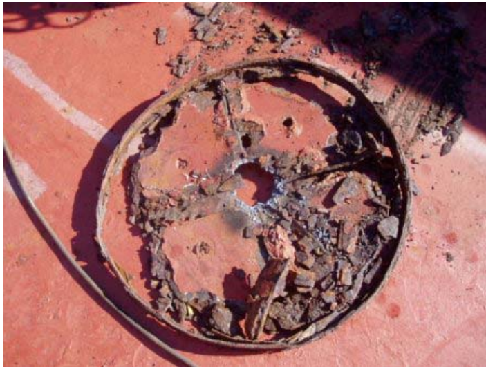
Εικόνα γ20: Hold mushroom vents closing discs corroded, disc holed
