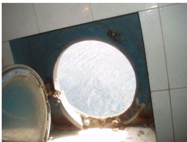
Εικόνα γ53: Damaged frame
