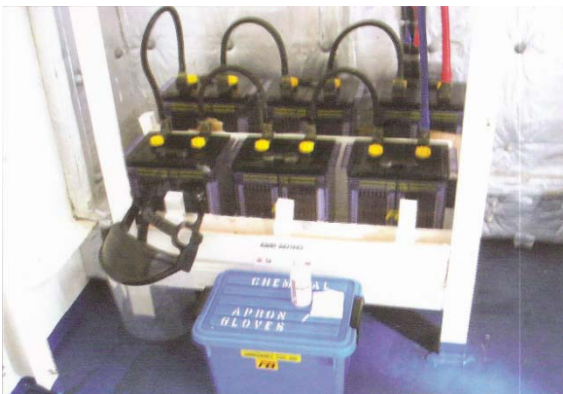
Εικόνα γ58 : Batteries in good condition
