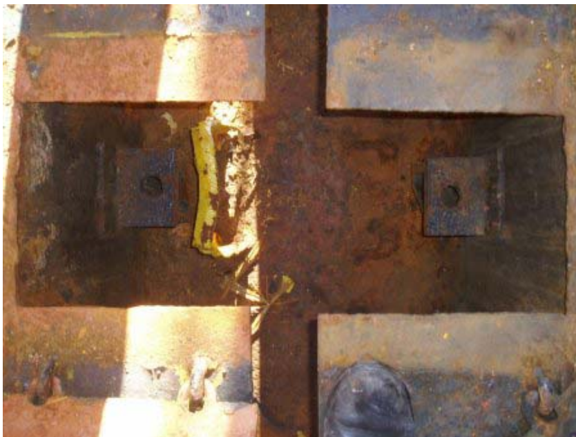
Εικόνα γ41: Hatch cover securing cleats not secured
