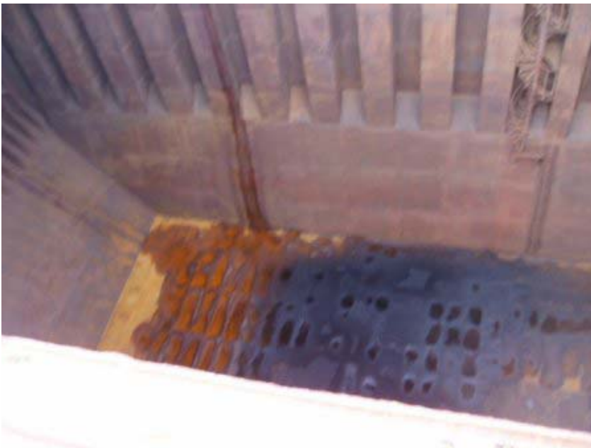
Εικόνα γ50 : Bulkhead corroded and leaking
