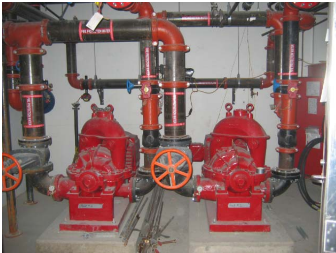
Εικόνα γ33: Fire pumps
