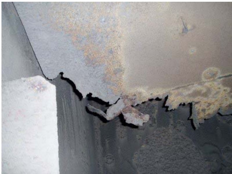
Εικόνα 11: Engine Room fan fire damper corroded and wasted
