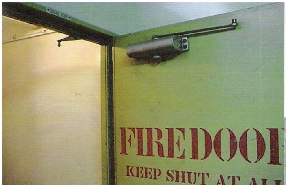
Εικόνα γ45 : Fire door release mechanism out of order
