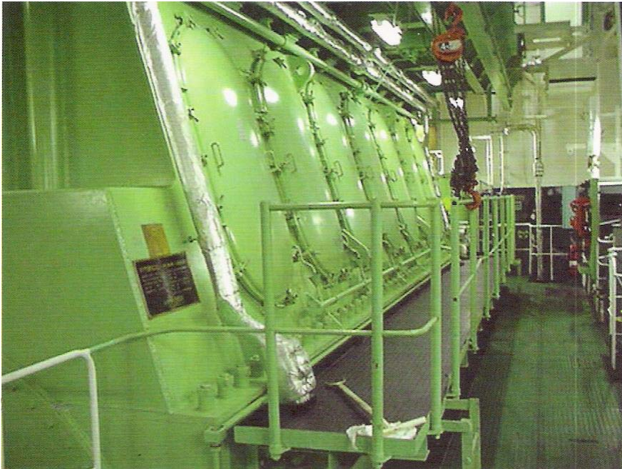
Εικόνα γ65: Engine room in good condition
