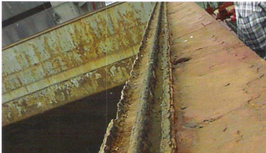
Εικόνα γ43 : hatch coaming in bad condition
