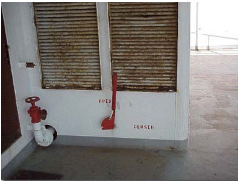
Εικόνα γ18: Manually operated fire-damper
