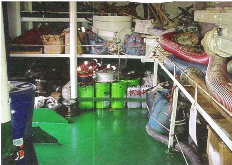
Εικόνα γ64 : SOPEP equipment in bad condition
