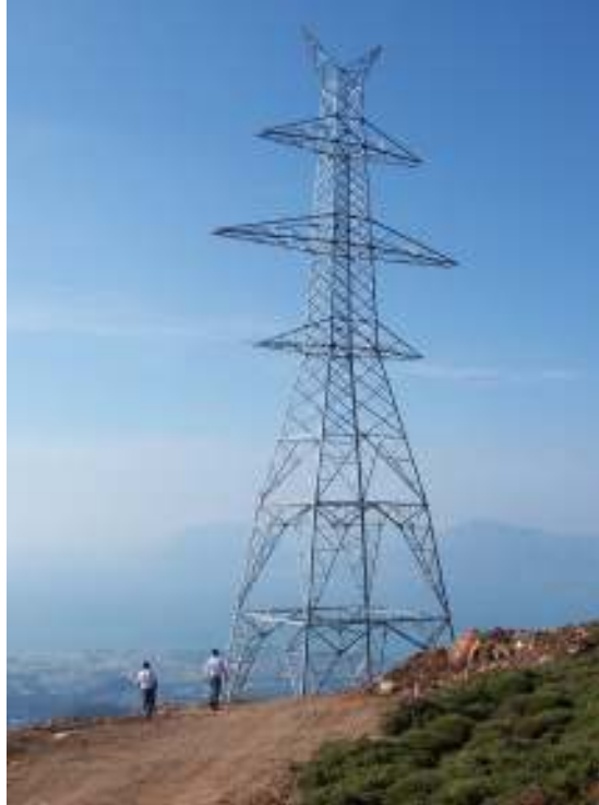
Φωτογραφία 4.3.3. Πυλώνας Υψηλής Τάσης βαρέως τύπου
