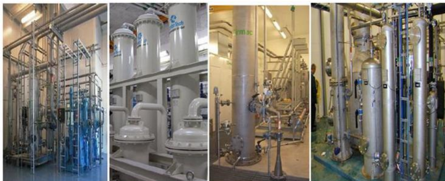
Εικόνα 3.3: Μονάδες αναβάθμισης βιοαερίου στη Σουηδία [100]
