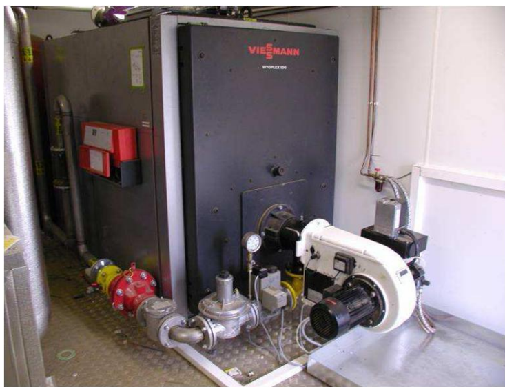
Εικόνα 6.1: Καυστήρας βιοαερίου για παραγωγή θερμότητας [84]
