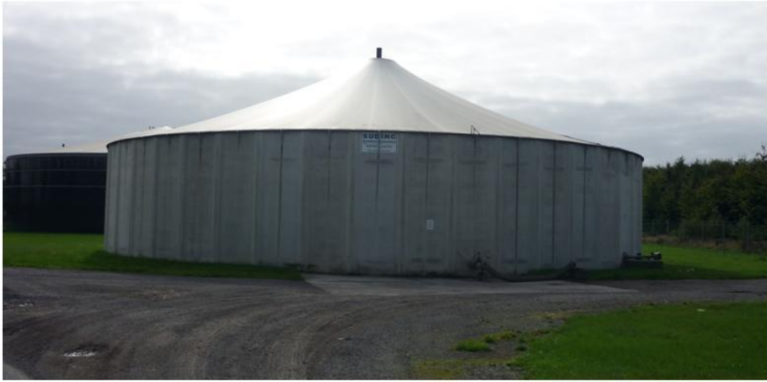
Εικόνα 11.4: Δεξαμενή αποθήκευσης υγρής κοπριάς από οπλισμένο σκυρόδεμα, εφοδιασμένη με πλαστικό κάλυμμα [84]
