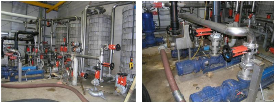
Εικόνα 11.6: Συστήματα αντλιών σωληνώσεων και αυτόματων βαλβίδων διακοπής και άντλησης εντός προστατευτικού οικίσκου [84]
