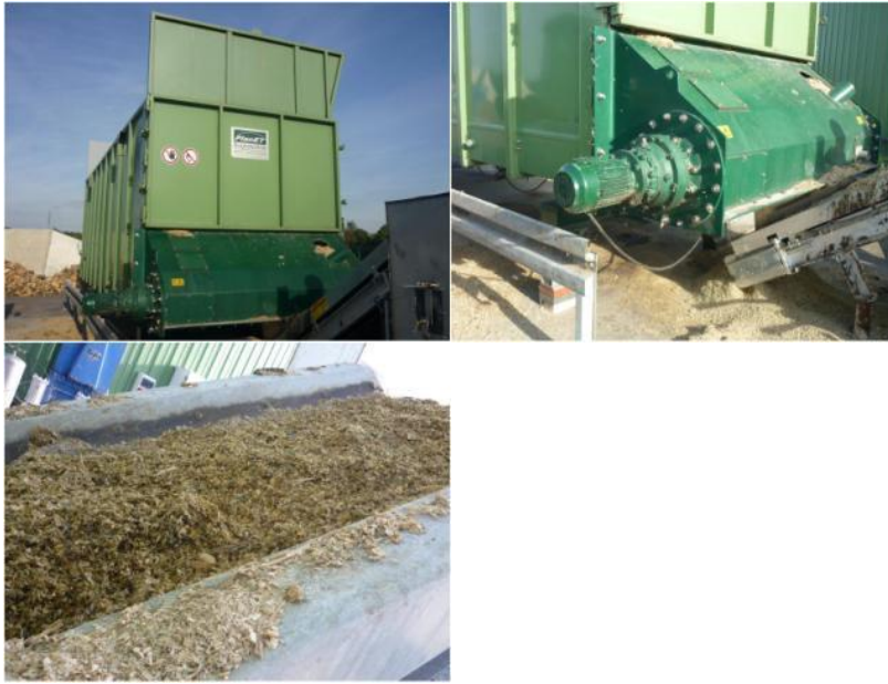
Εικόνα 11.5: Σύστημα τεμαχισμού ενσιρώματος και μεταφοράς στο εσωτερικό του αντιδραστήρα χώνευσης [84]
