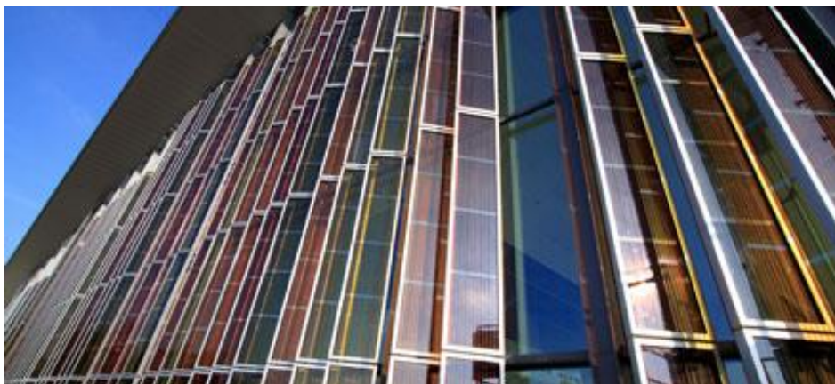
Σχήμα 1-3. Φωτοβολταϊκά σε πρόσοψη κτιρίου (EMD performance materials)
