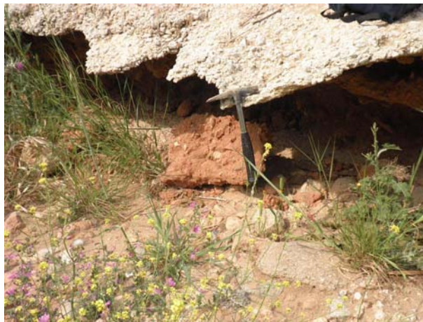
Σχήμα Π7.10: Παρουσία διάβρωσης της θέσης S9.
