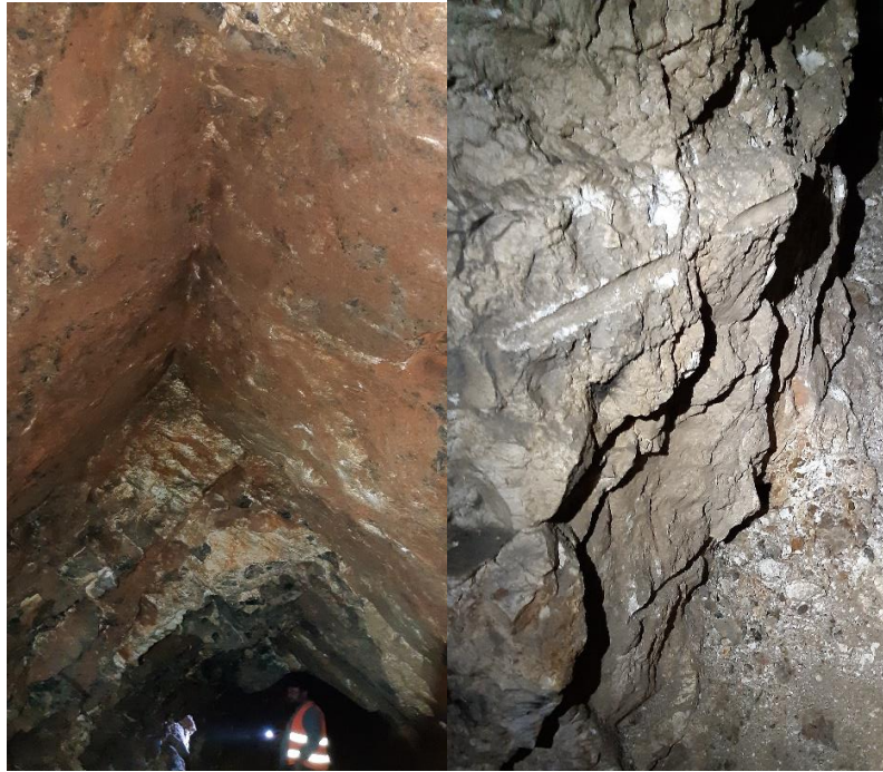
Εικόνα 6.9: Αστοχία τύπου σφήνας στο ταβάνι της κεντρικής στοάς (αριστερά) και ίχνος διατρήματος για τοποθέτηση εκρηκτικών υλών (δυναμίτης) (δεξιά)
