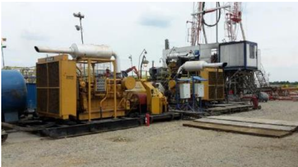
Εικόνα 4-3 Αντλίες διακίνησης του ρευστού διάτρησης (Balac, 2019)
