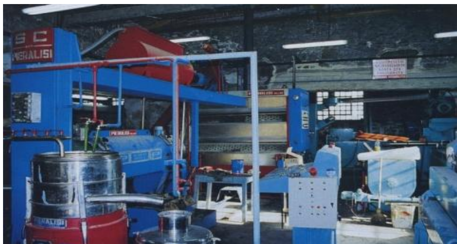
Εικόνα 1-3: Το εσωτερικό ενός ελαιοτριβείου φυγοκεντρικού τύπου τριών φάσεων στη Λέσβο
