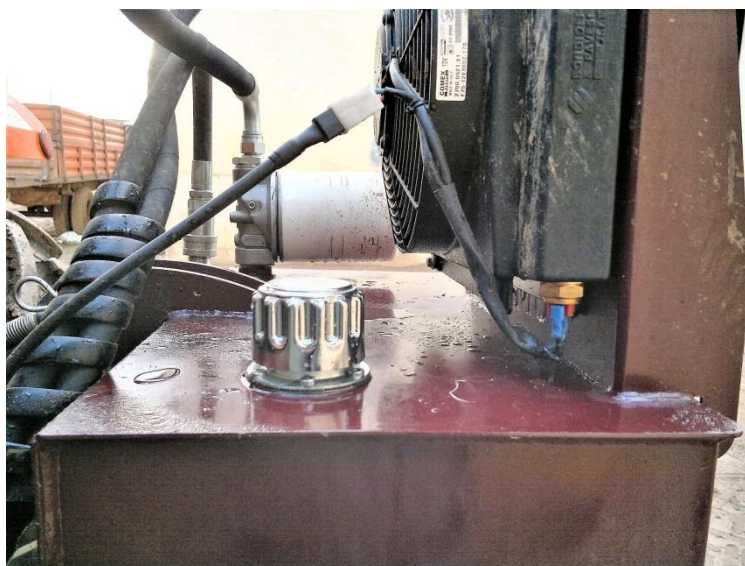
Reservatório de óleo com o respectivo bujão de enchimento
