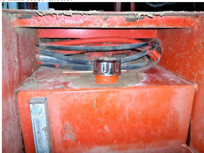
Reservatório de óleo com o respectivo bujão de enchimento e visor de nível
