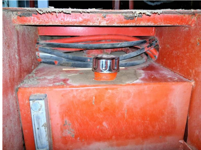
Reservatório de óleo com o respectivo bujão de enchimento e visor de nível
