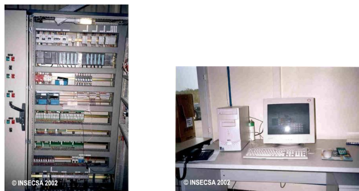
Imagen 2.37: Sistema de control.
