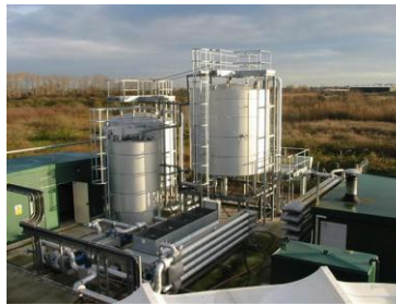
Imagen 2.45: Almacenamiento en Silo.
