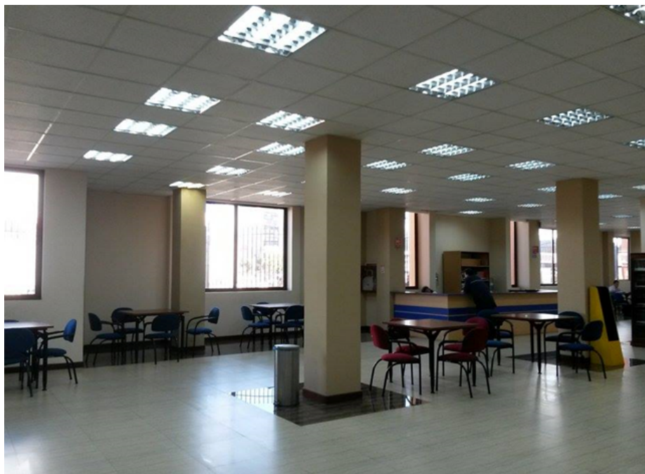
Figura 2.44: Ejemplo de los soportes de las luminarias fluorescentes
