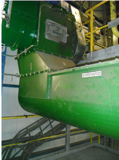
Obr. 22 Prívod (cesta) štěpky do fluidního kotle K7
