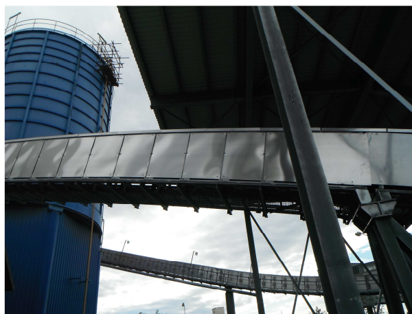
Obr. 19 Samostatná trasa dodatkového paliva (palmové ořšky, uhelné kaly, pivovarské mláto) do kotle K6
