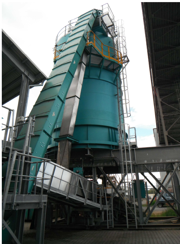
Obr. 18 Silo na skladování dodatkového paliva (palmové ořšky, uhelné kaly, pivovarské mláto) do kotle K6
