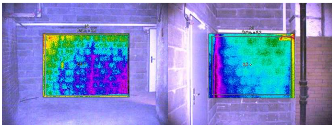
Obr. 11. 38 a 11.39. Průměrná teplota levé stěny byla 6,5°C a pravé stěny 6,3°C.
