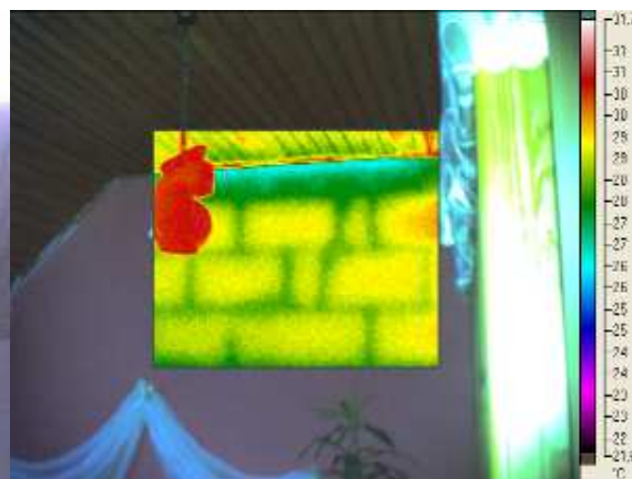
Obr. 11.18 V horní části problém s tepelným únikem a vnitřní stěna je vlhká
