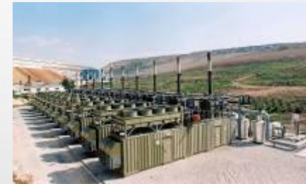
Μονάδα βιοαερίου 13,8 MWe (Πηγή: ΗΛΕΚΤΩΡ ΑΕ, Ελλάδα)
