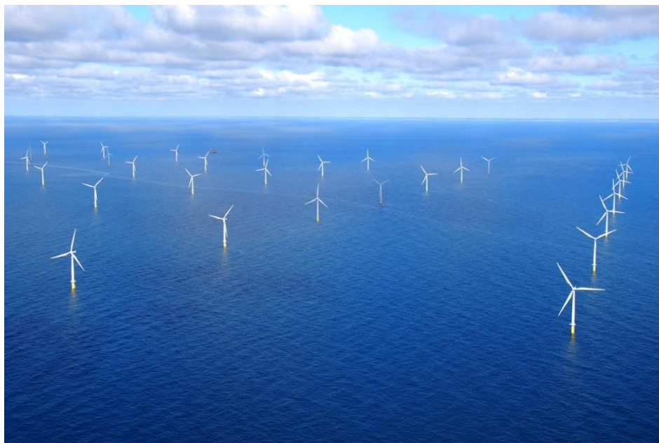
Havmøllepark (Foto: Energinet.dk).
