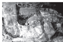
Detalle, pérdida del relieve y soporte de piedra.
