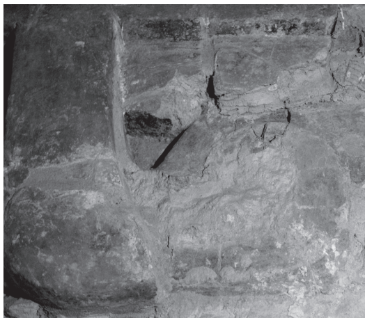
Figura 6. Relieve que perdió parcialmente el soporte y recubrimiento de estuco. Véase la huella dejada por la superposición directa de los gruesos volúmenes de estuco.
