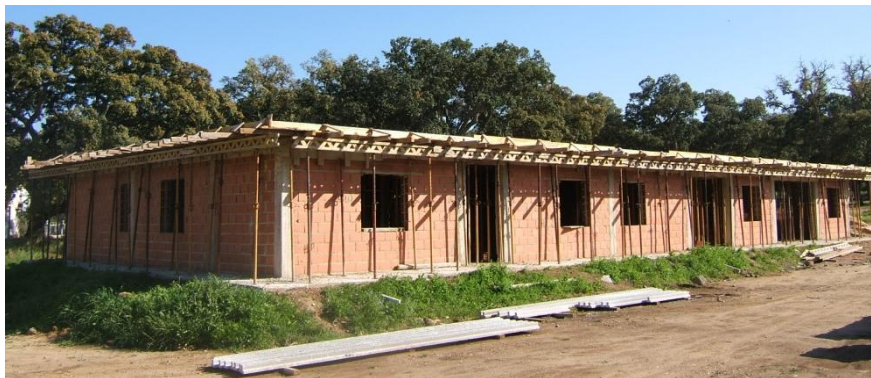
Figura 2.14. Moradia em construção, com estrutura de betão armado e laje de vigotas pré-tensionadas.
