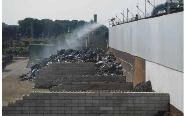
Einsatz von Nebelkanonen am Kondirator
