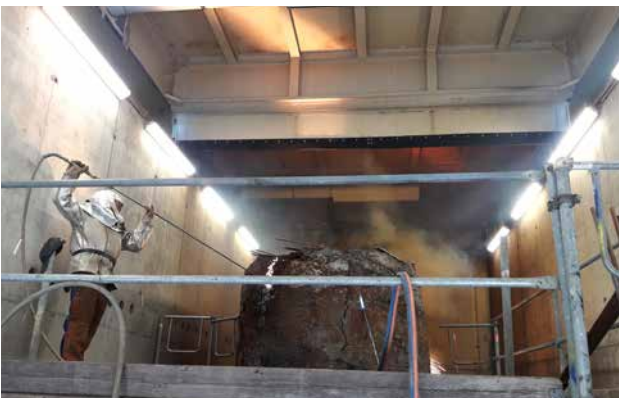
Neue Einhausung Brennerbox mit Anschluss an Entstaubungsanlage im Fallwerk
