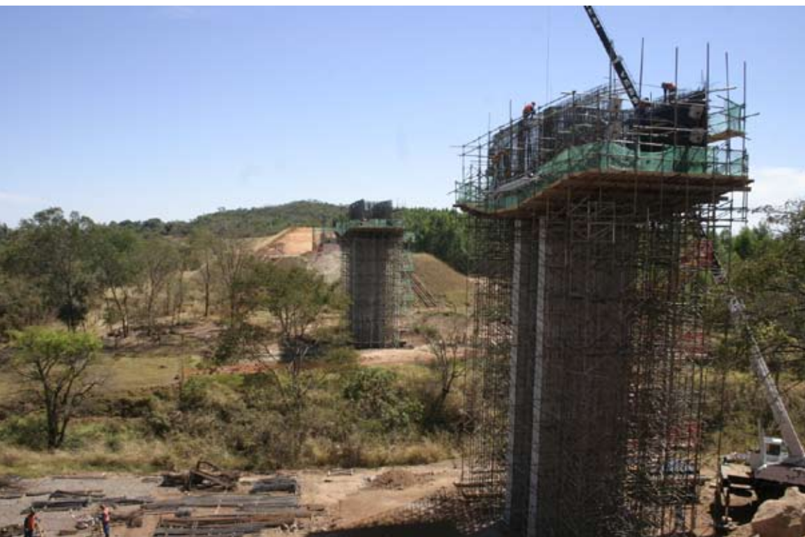
Obras na Ferrovia Norte-Sul: projeto para produção de 6 milhões de toneladas de soja destinadas à China
