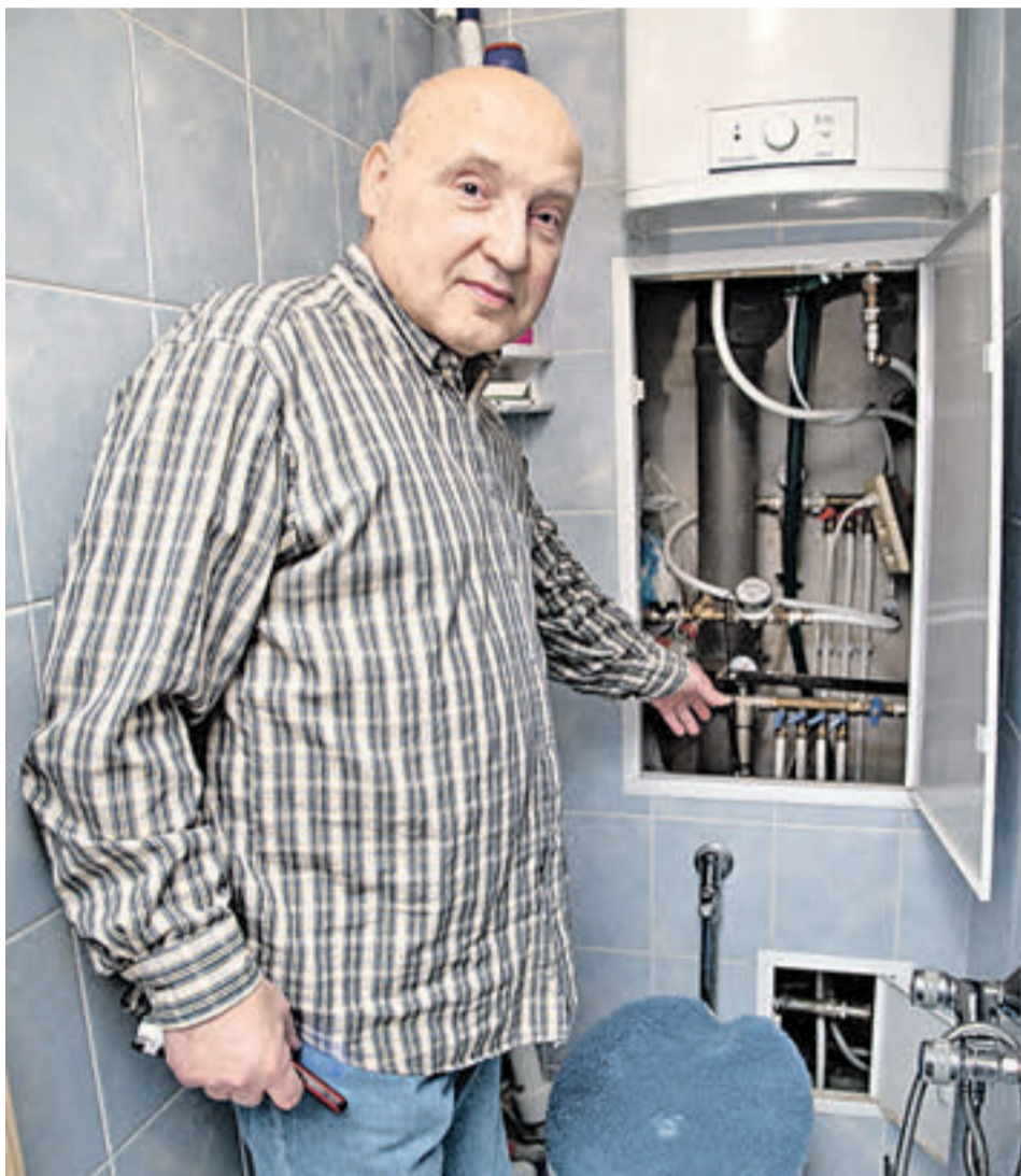
Сергей Блинов вот уже второй год живет в холодной квартире. Неполадки начались, когда сантехник неправильно поменял батареи в одной из комнат
