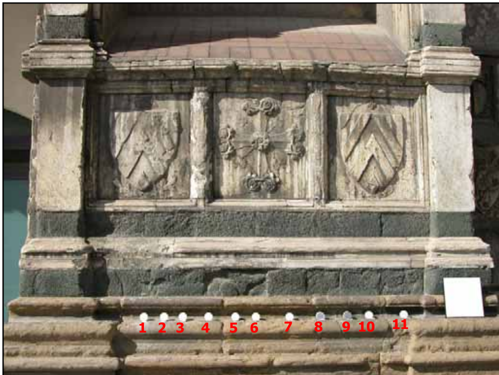
Fig. 3.41 - Avello a sinistra della facciata della chiesa (cfr. Fig. 3.1 a) dove sono visibili le pasticche standard posizionate sulla scena prima dell'acquisizione dell'immagine Hyper SIM-GA.
