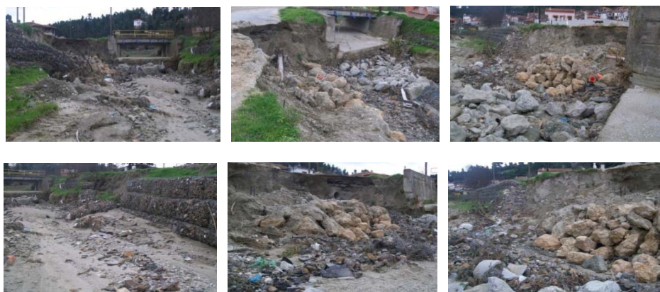
Εικόνα 6. Απόψεις των αξονικών και πρανικών διαβρώσεων στο ύψος της γέφυρας προς το νεκροταφείο Κασσανδρηνού (Σχ.7. Τμήμα I).
