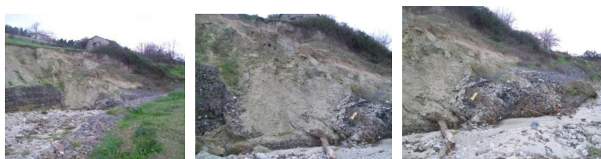
Εικόνα 9. Απόψεις ενεργοποιηθείσας πρανικής ολίσθησης στα όρια των τμημάτων II και III (Σχ. 7).
