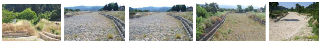
Εικόνα 3. Απόψεις της διευθετημένης με συρματοπλεκτες κατασκευές (κιβώτια, κύλινδροι, στρωμένες), κεντρικής κοίτης του χειμάρρου Φούρκας.
