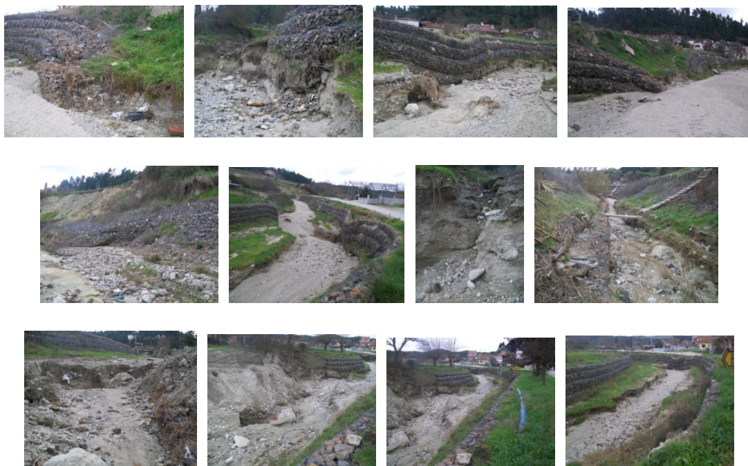
Εικόνα 5. Απόψεις των αξονικών και πρανικών διαβρώσεων στο κεντρικό τμήμα του κλάδου Κασσανδρηνού στο ύψος του οικισμού (Σχ. 7, Τμήμα II).
