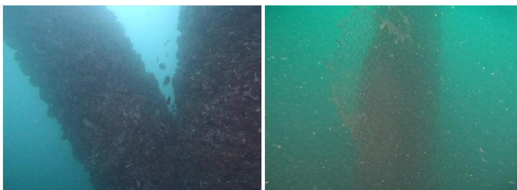
圖 2.1.6-1 D01 基樁表面生長藤壺、纏繞廢棄漁網照
