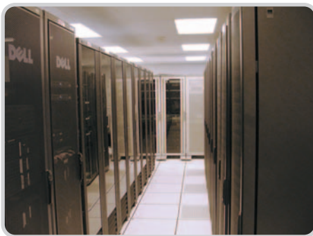
Los proveedores suelen contar con instalaciones propias en las que disponen de racks con varios servidores preparados para dar servicio a múltiples usuarios.
