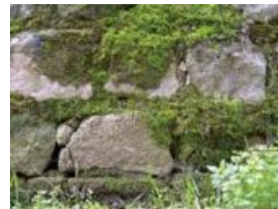
Foto 3. Briófitas habitando bloques de piedra y concreto.
