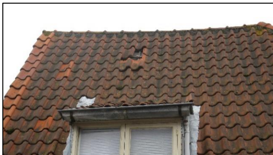
Foto 3: Gat tussen dakpannen
