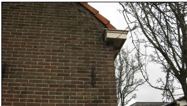
Foto 2: Opening onder dakgoot, geschikt als verblijfplaats voor vleermuizen
