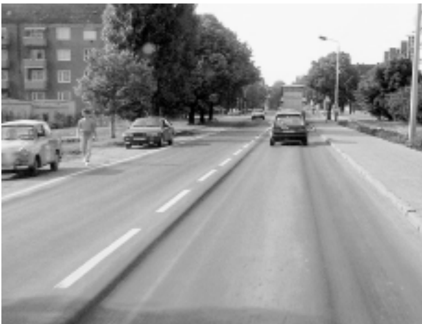
Abb. 1: Spurrinnen im Asphalt
