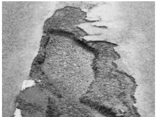
Abb. 3: Substanzverlust in der Asphaltdecke
