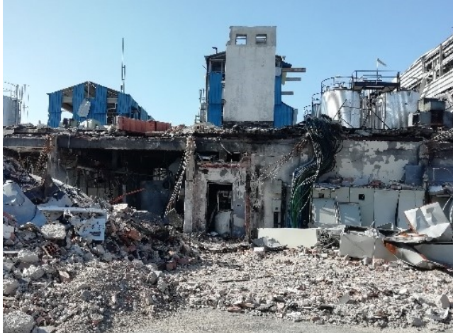
Figura 4-10. Edifici de la sala de control destrossat
