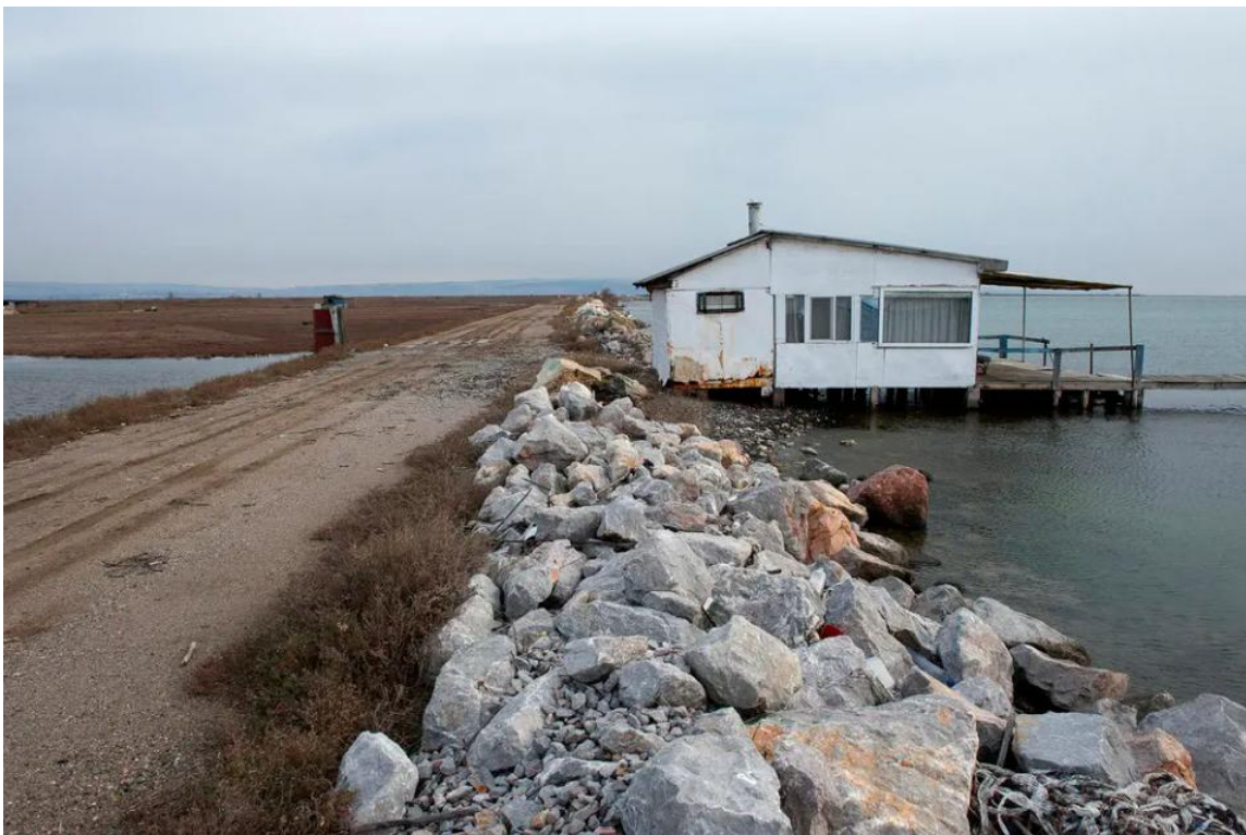
Εικ.Δ6: Παράκτιο ανάχωμα που υπόκειται σε διάβρωση από την δράση της θάλασσας.
