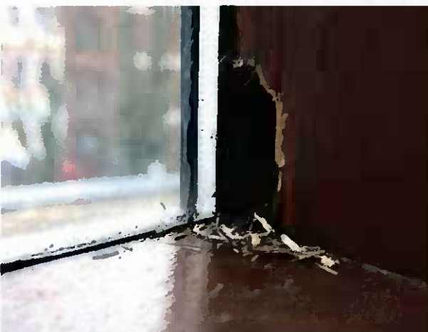
Abb. 6 Beispiel eines Holzschadens durch Wassereintritt
