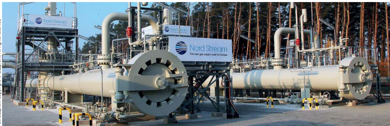
Fot. 6. Nord Stream, stacja pomiarowa Greifswald (Niemcy)
